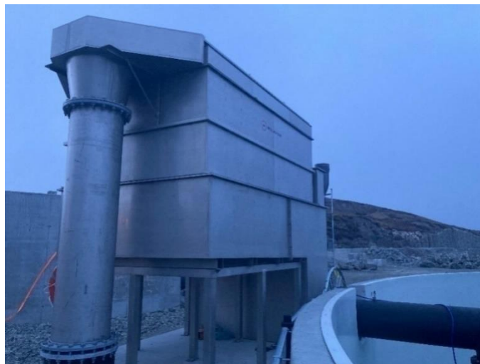
CO 2 Lufter i pilotanlegget tilpassa BUE sitt behov.
